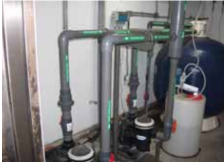
High water tank Ondjiva.
